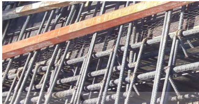
Gambar 3.36 Stop cor Sumber : Dokumentasi Pribadi, 2015
